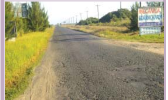
Resta saber se o recapeamento asfáltico não será colocado sobre a grama no meio fio.
